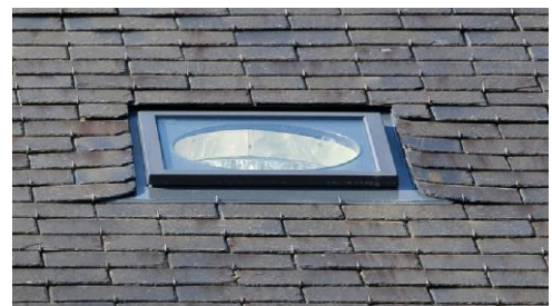
Intégration du module extérieur
